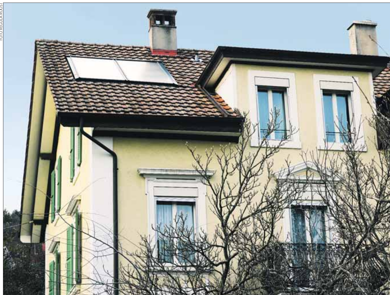
Als Erstes wurden Sonnenkollektoren für die Wassererwärmung montiert. Auf dem Programm sind nun die Innendämmung des Daches, Wärmeschutzfenster und eine Holzpellets-Heizung.
