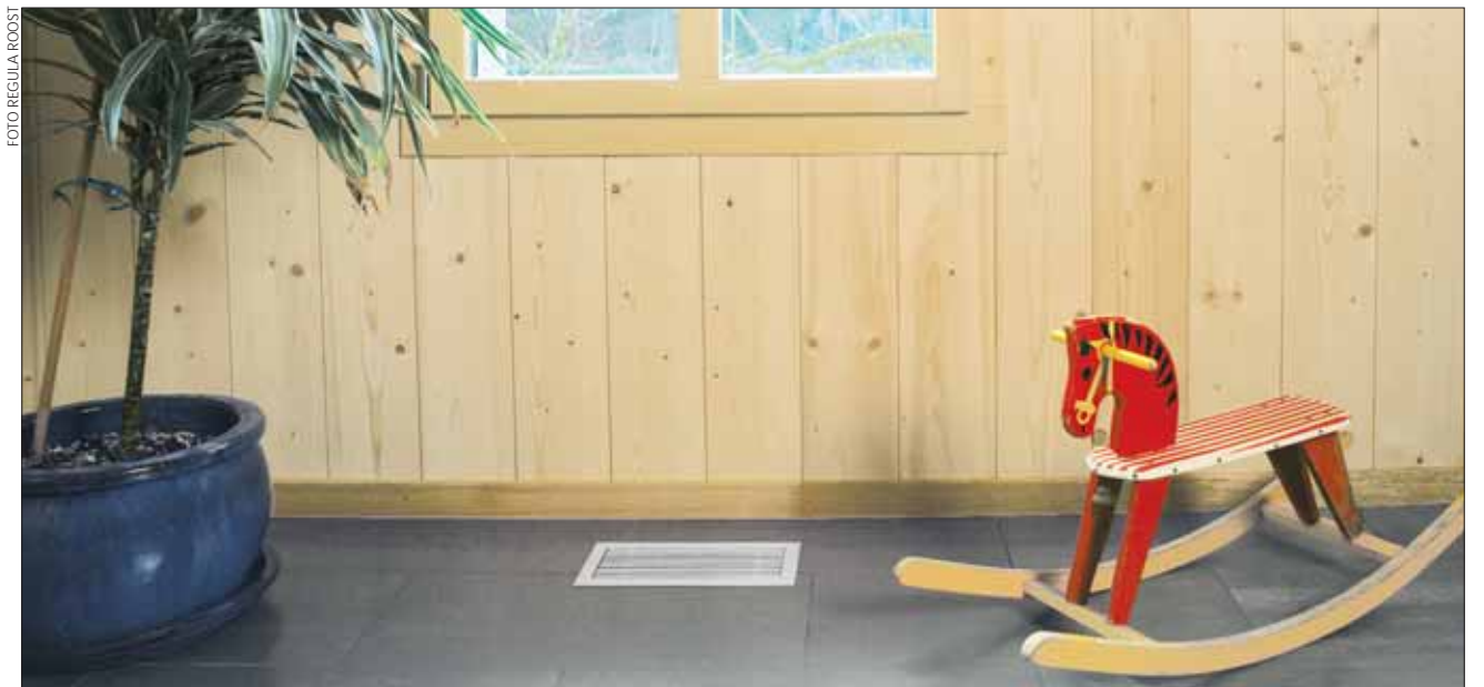
Durch die Lüftungsschlitze in den Wohn- und Schlafräumen kommt Tag und Nacht frische Luft ins Haus.
